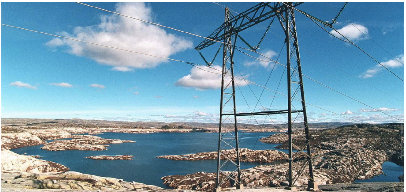
High voltage power system | Photo: Teknisk Ukeblad, tu.no
